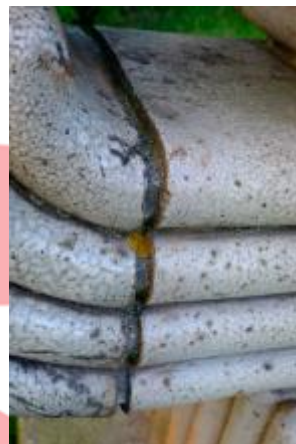
Detail spáry mezi jednotlivými keramickými dílci vč. biologického napadení 08/2016 PHe
