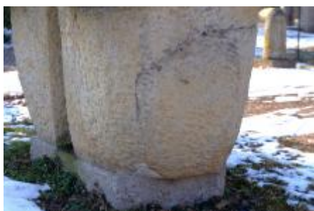
Detail poškození - praskliny v kameni (12/2017 PHe)
